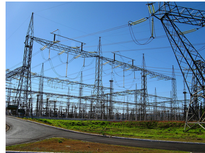
Figura 1. Equipamentos elétricos presentes em subestações e suas catenárias.
